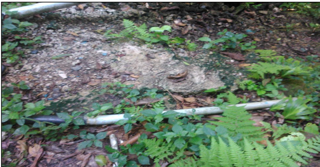
Figura 7: Línea de Conducción expuesta
