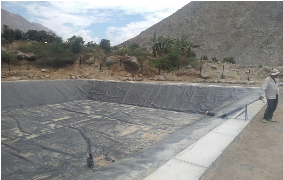
Figura 18: Reservorio de 700 m 3 de capacidad, instalado en la parcela comunal de la Comunidad Campesina de Quintay
