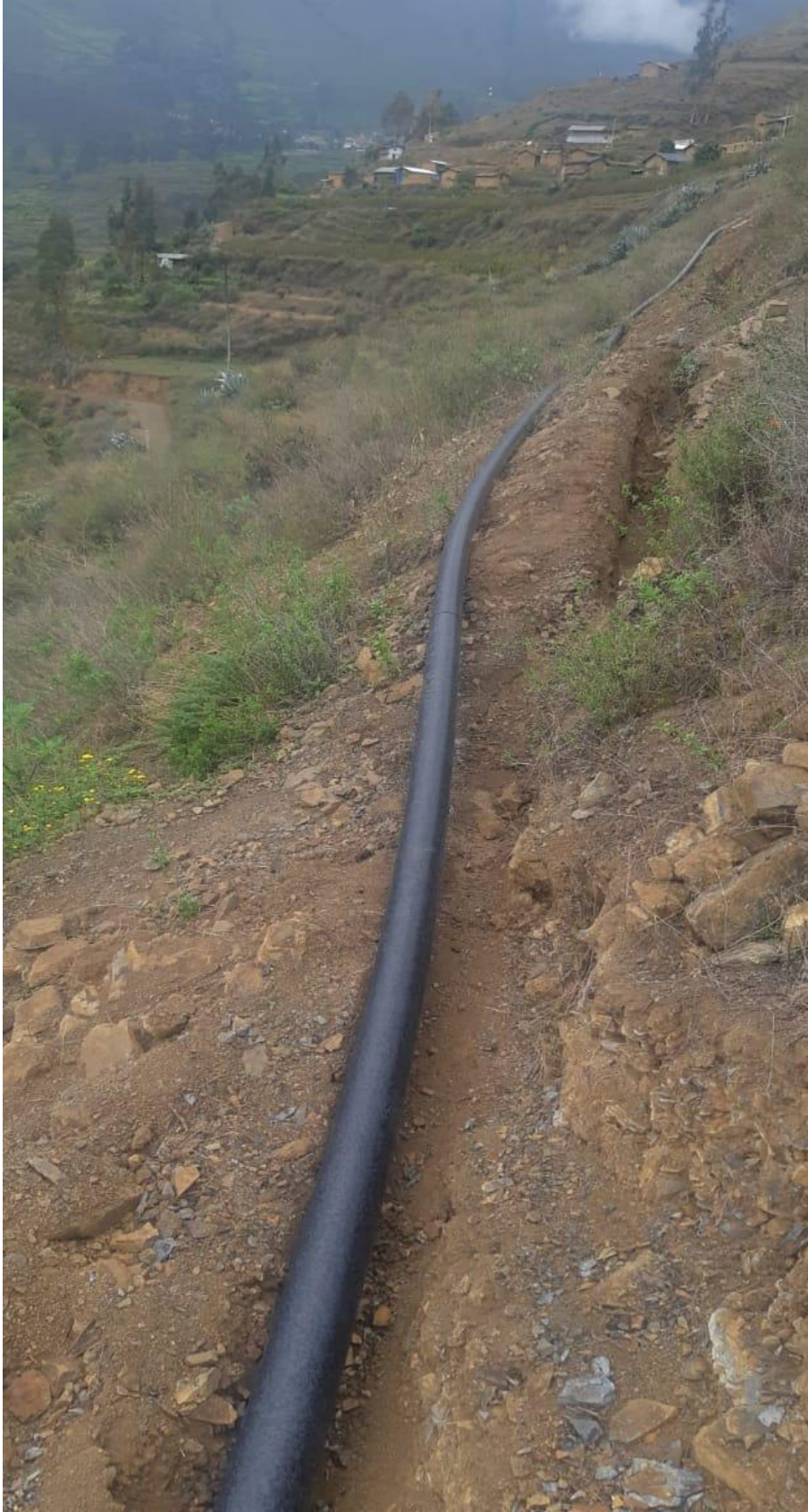
Figura 17: Ejecución del del sistema de conducción de agua para riego en el Sector Punga en la Comunidad Campesina de Huacar
