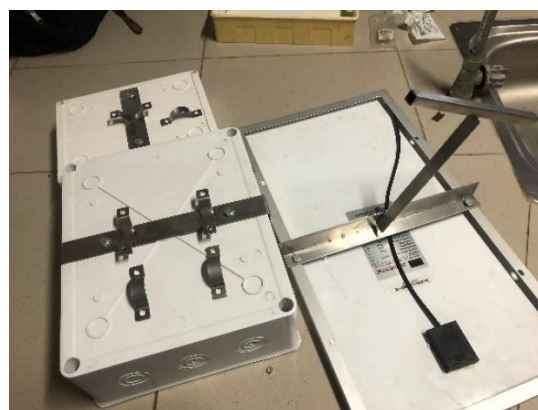
Figura 167: Estructuras en acero inoxidable de reemplazo para panel solar y cajas de protección.
