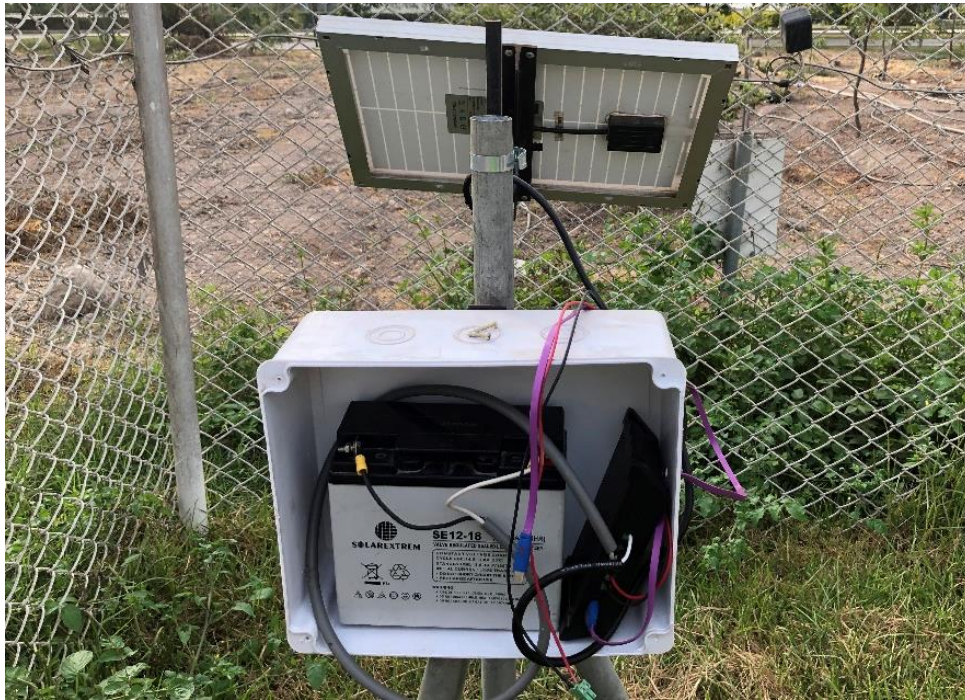
Figura 56: Vista posterior del panel solar y frontal de la caja de protección de la batería y el regulador de carga.
