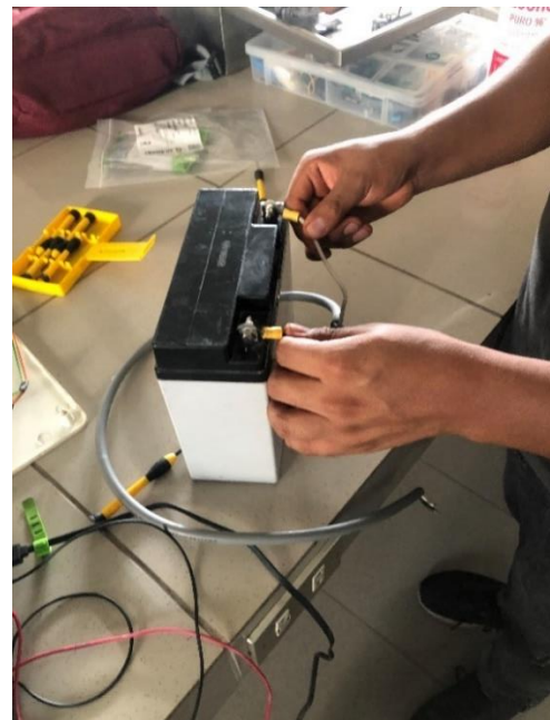
Figura 129: Conexión de cables con batería solar.
