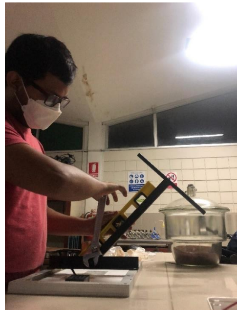
Figura 125: Ajuste angular de la estructura de soporte del panel solar.
