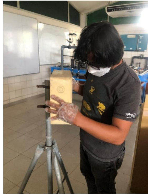
Figura 127: Colocación de caja de protección de batería y regulador sobre mástil.
