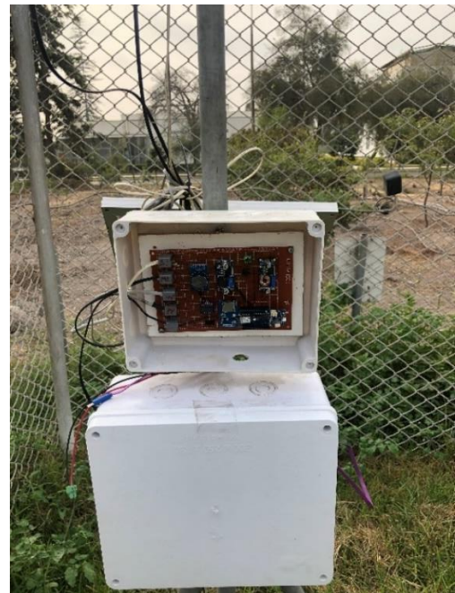
Figura 153: Vista del subsistema de gestión de datos con prototipo instalado en campo.
