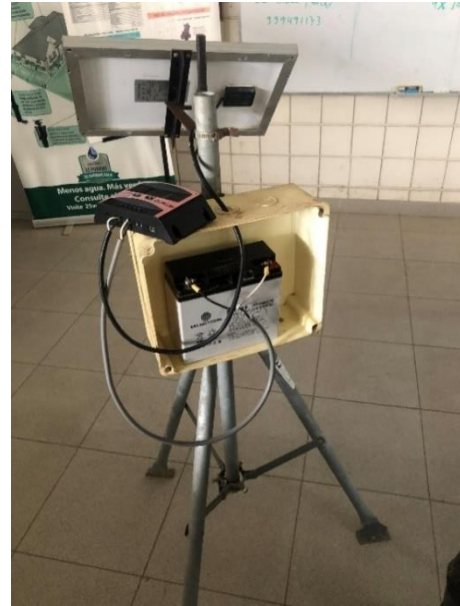
Figura 131: Conexión de controlador de carga solar con batería y panel solar.
