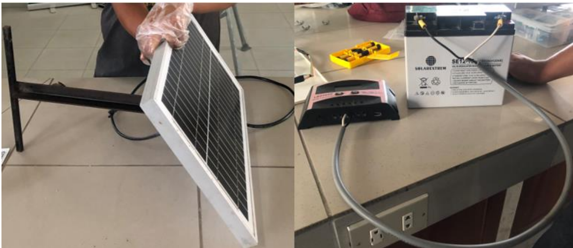
Figura 55: A la izquierda está el panel solar con su estructura de sujeción y soporte, y a la derecha, la batería solar y el controlador de carga conectados entre sí.
