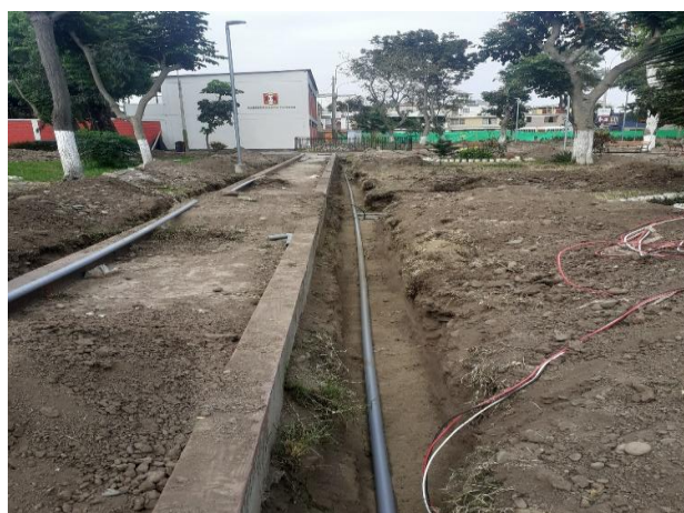
Figura 26: Entubado del campo
