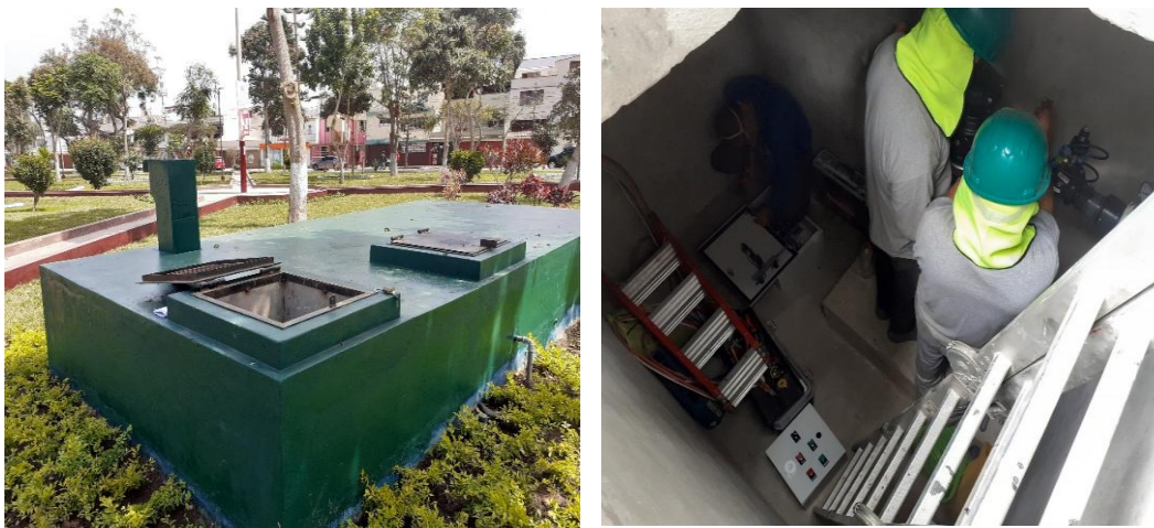
Figura 25: Cisterna y cuarto de maquina
