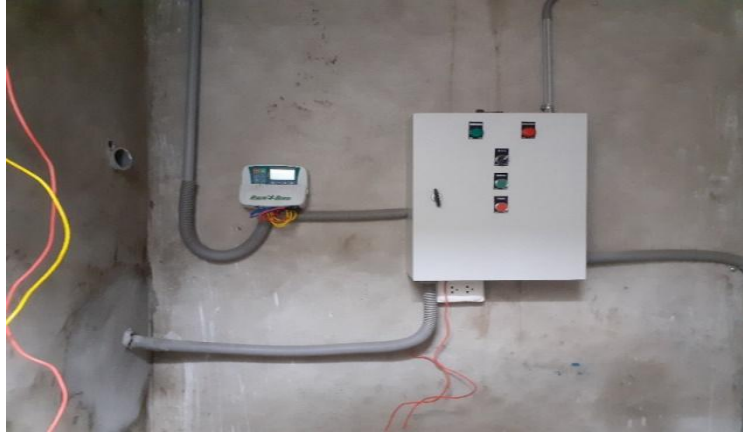
Figura 28: Instalación del taimer y el tablero eléctrico
