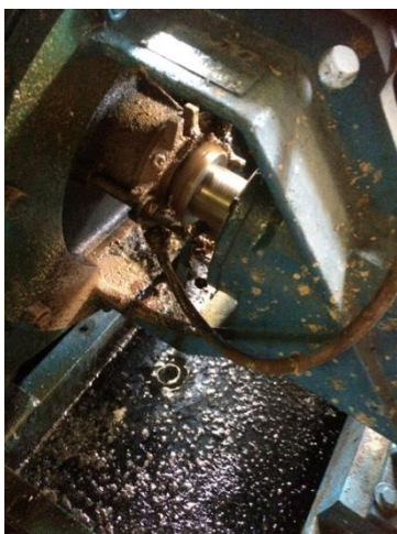
Figura 12: Bomba de jugo clarificado con fuga de jugo
