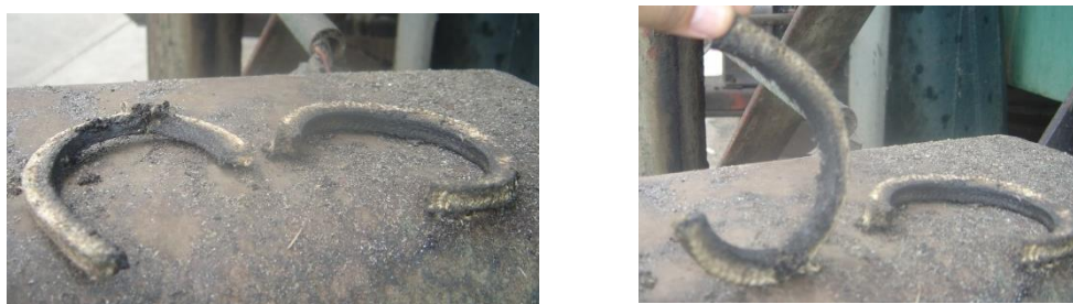
Figura 16: Empaques usados de bombas de circulación
