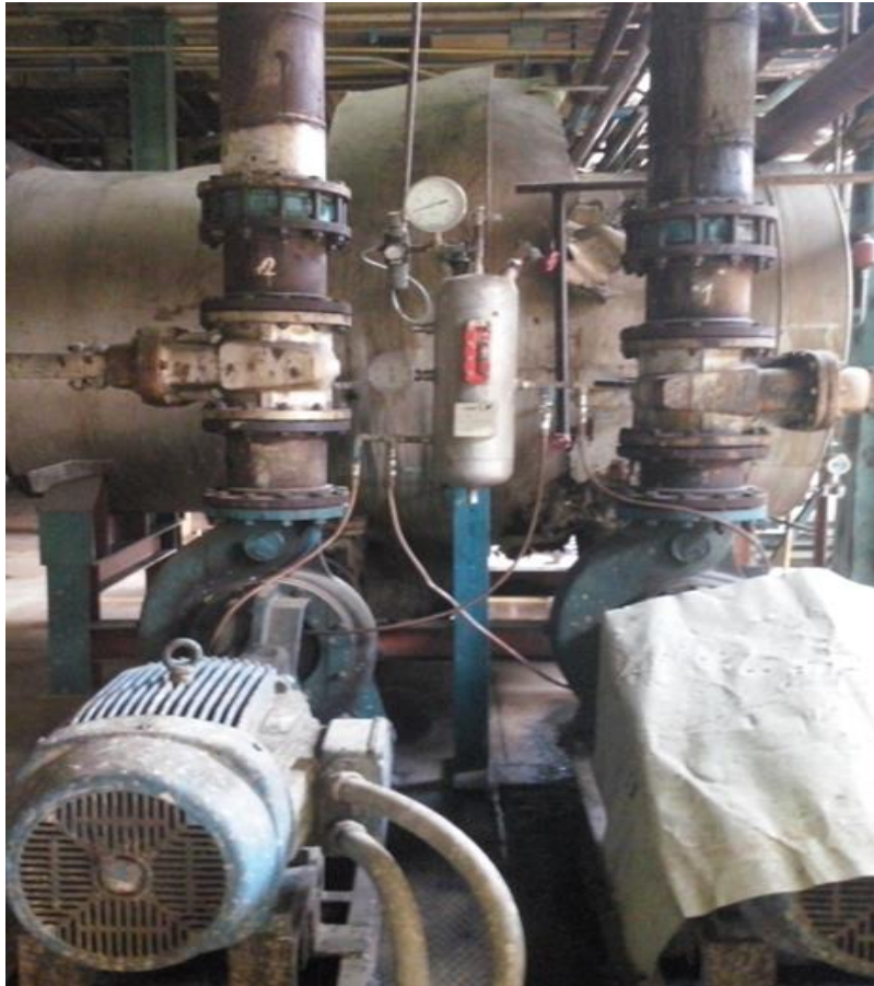
Figura 22: Tanque auxiliar - instalación con 2 bombas
