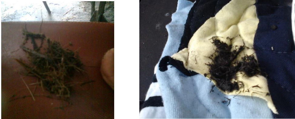
Figura 14: Bagacillo en caja estopera de bombas zona de extracción
