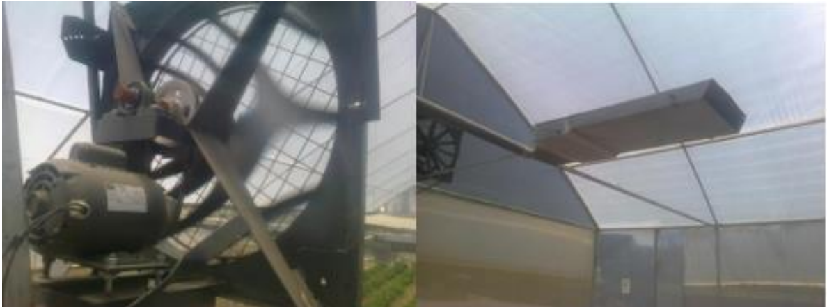
Figura 23. Ventilador y estufa en el invernadero.
