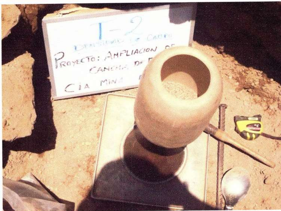
Fotografía N° 19: Calibración de equipos y realización de la prueba de densidad de campo en la Trinchera T-2.
