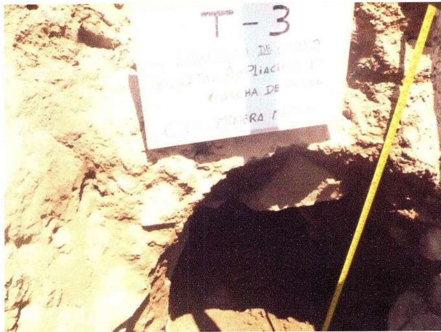
Fotografía N° 20: Vista de la Trinchera T-3 ubicada en el talud del depósito de relaves en operación. Se observa la presencia de arena limosa mal gradada con bolonería de 70 a 90 cm.
