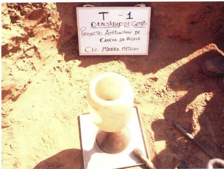
Fotografía N° 17: Calibración de equipos y ejecución de la prueba de densidad de campo en la Trinchera T-1.
