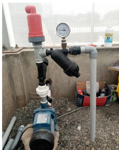
Figura 11: Arco de riego instalado.
