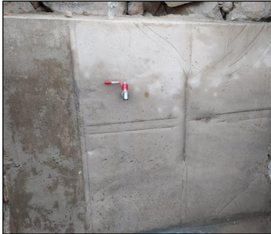
Figura 33: Pileta publica de distribución de agua del filtro lento de arena intermitente (FLAI)
