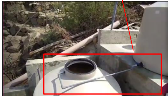
Figura 32: Conexión del tanque recolector y tanque de filtración (FLAI)
