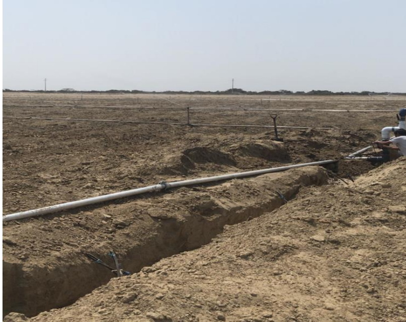
Figura 27: Instalación de la línea de aspersores a la matriz de riego.
