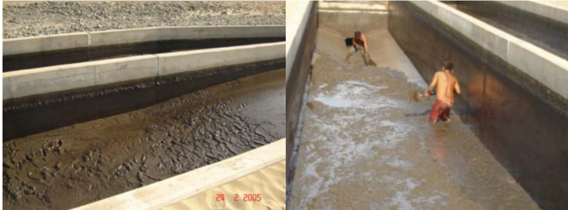
Figura 21: Desarenador colapsado por exceso de SS, de manera similar a la anterior Figura.
