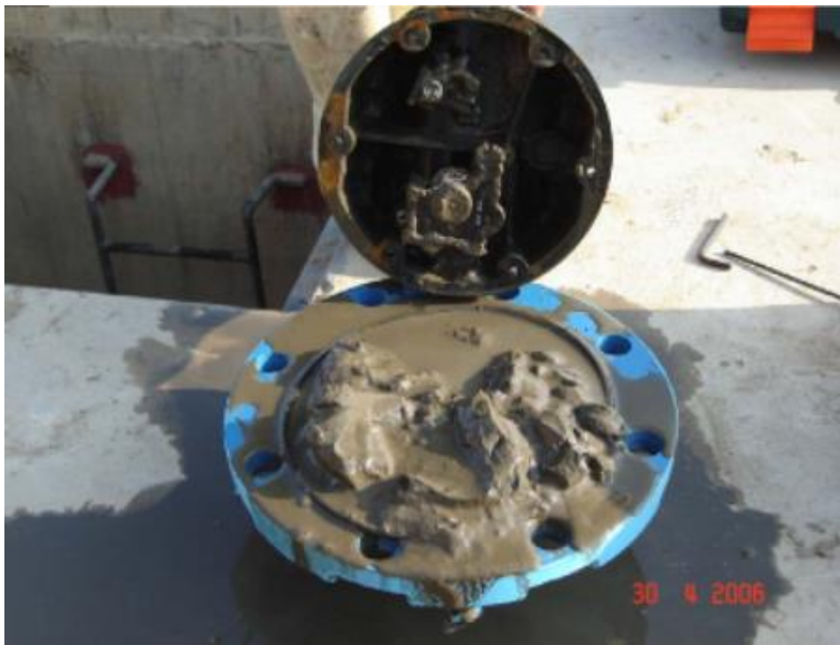
Figura 22: Colapso de una válvula hidráulica de un sistema de riego por exceso de SS. Se abrió la brida para la limpieza del sistema.
