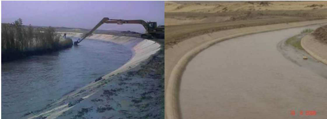
Figura 19: Canal Madre lleno de lodos. Obsérvese (derecha) en montículo de sedimentos que se han acumulado en el lado interior de la curva, a modo de una “orilla”, lo que reduce la capacidad del canal.
