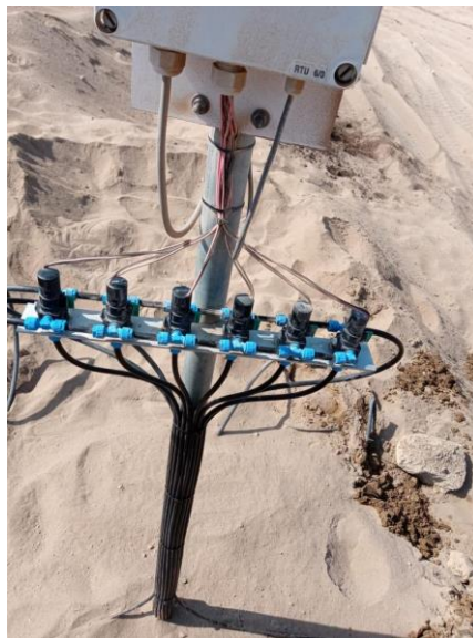
Figura 33: Instalación de solenoide
