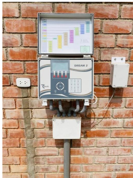
Figura 65: Controlador de riego
