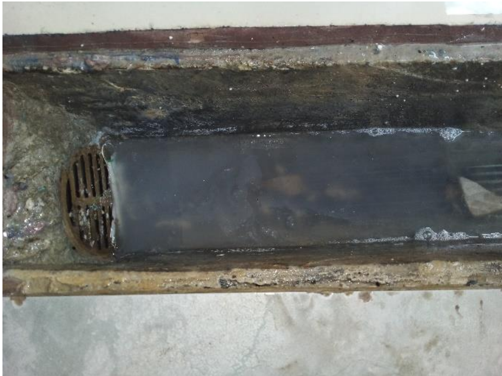
Figura 8. Flujo de agua de lavado en la alcantarilla
