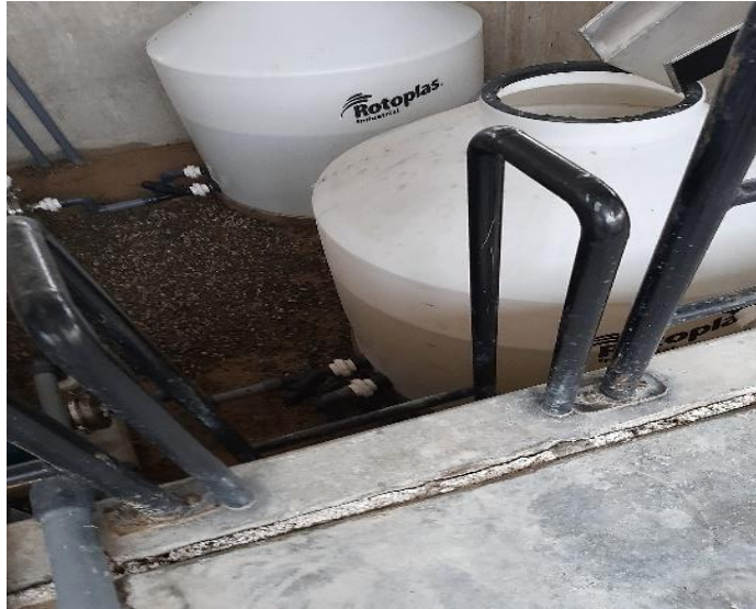
Figura 18. Tanque de preparación de capacidad de 2,000 L
