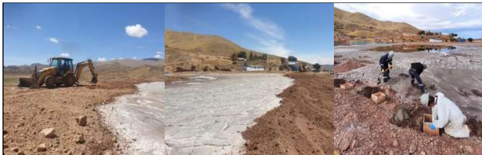
Figura 16: Generación de pendiente (izquierda) y preparación (centro) del área e instalación (derecha) de las celdas en el área experimental de relave minero.
