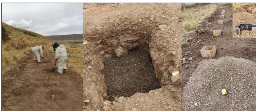
Figura 17: Preparación del área (izquierda), excavación para la colocación de la grava (centro) e instalación de las celdas en el área experimental de referencia.
