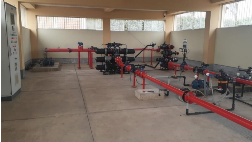
Figura 41: Casetta de riego
