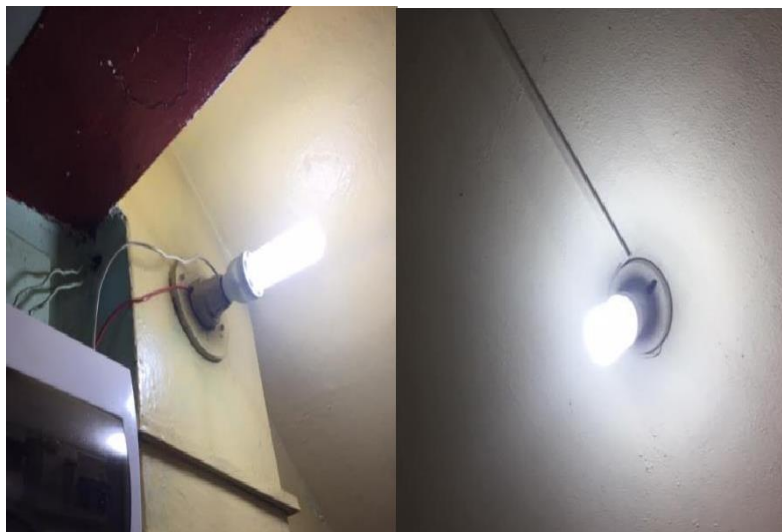
Figura 34: Luminaria sin mica protectora
