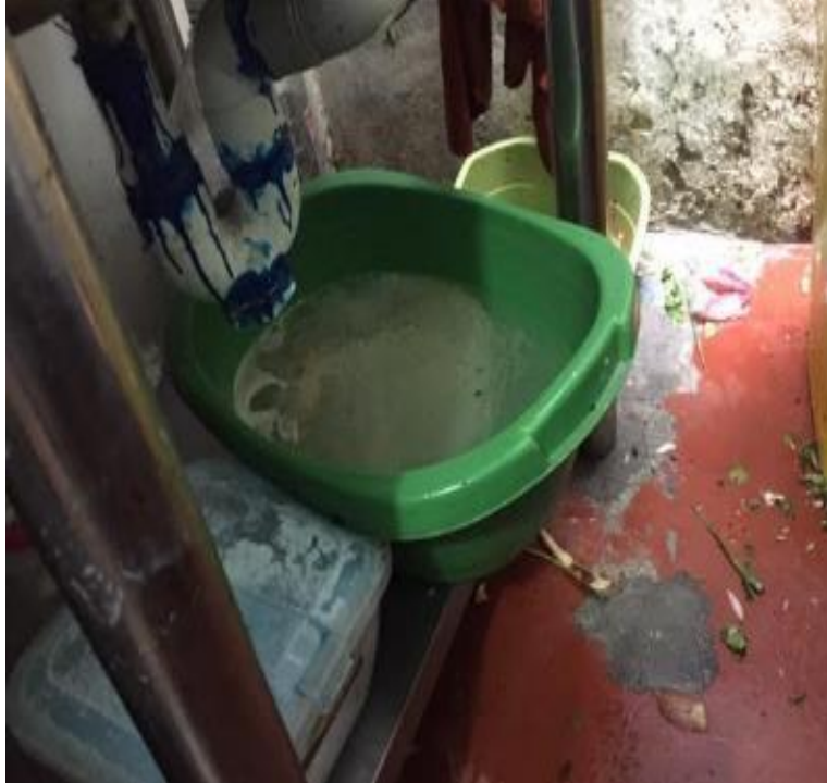
Figura 16: Cañerías con goteras
