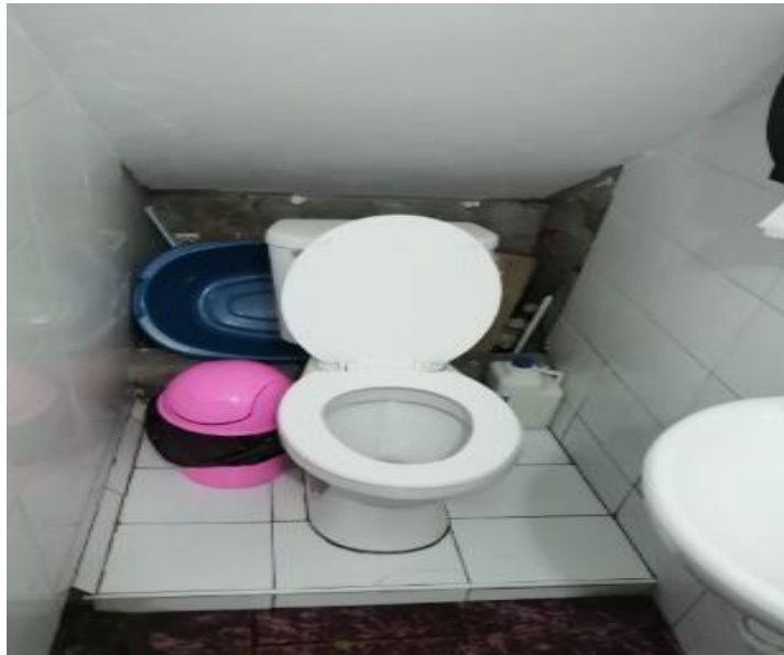
Figura 13: Se visualiza que los servicios higiénicos son usados como almacén de productos en desuso
