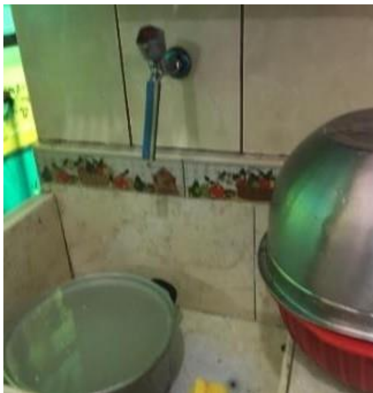
Figura 23: Lavadero sin cartel del procedimiento de lavado de manos
