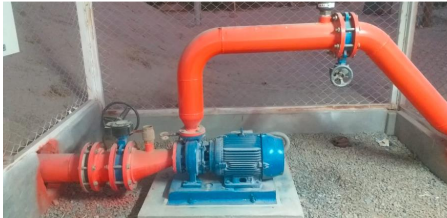
Figura 9. Cabezal de riego KSB
