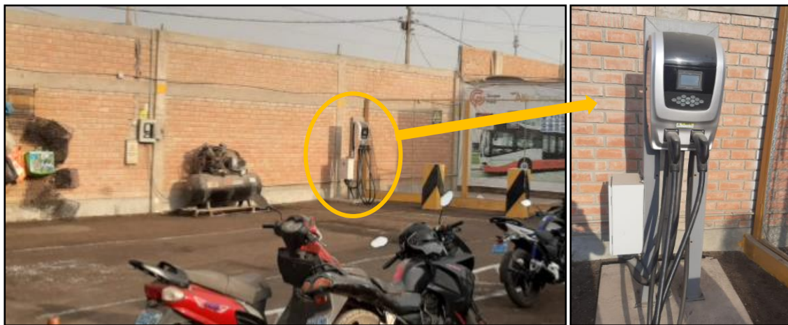
Figura 2. Estación de carga del bus eléctrico
