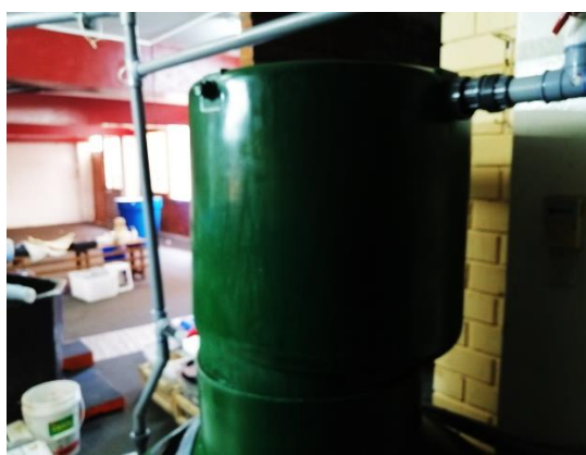
Biofiltro tipo percolador (parte inferior), con ingreso de agua por la parte superior, en forma de “lluvia”
