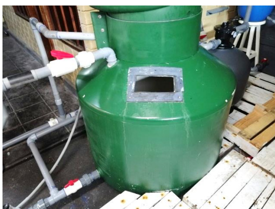
Tanque “sumidero” desde donde la bomba toma el agua. Se observa tuberías ‘by pass’
