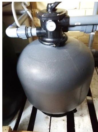
Figura 30: Vista del filtro de arena, presurizado
