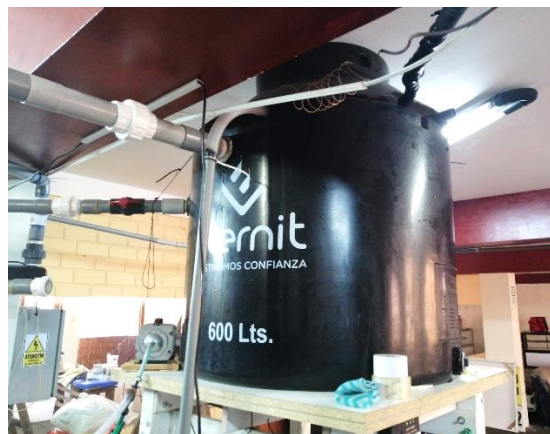
El tanque de enfriamiento, con un sistema cuyo funcionamiento puede ser mejorado
